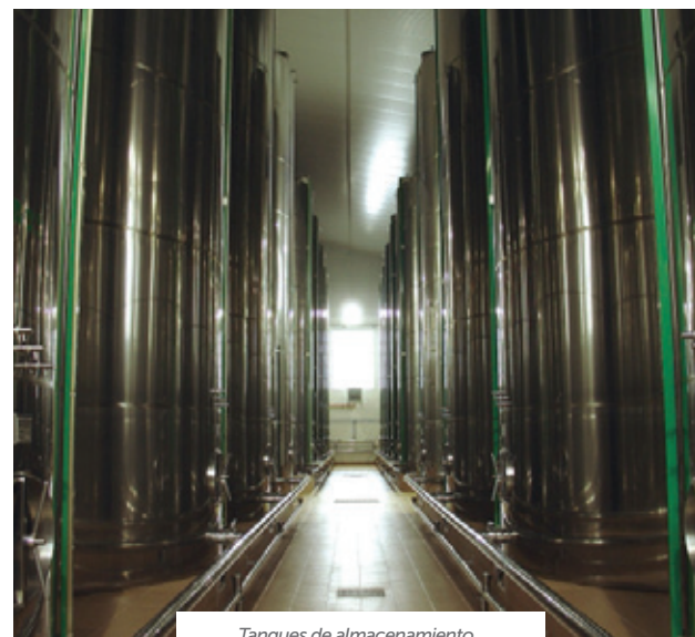
Tanques de almacenamiento
